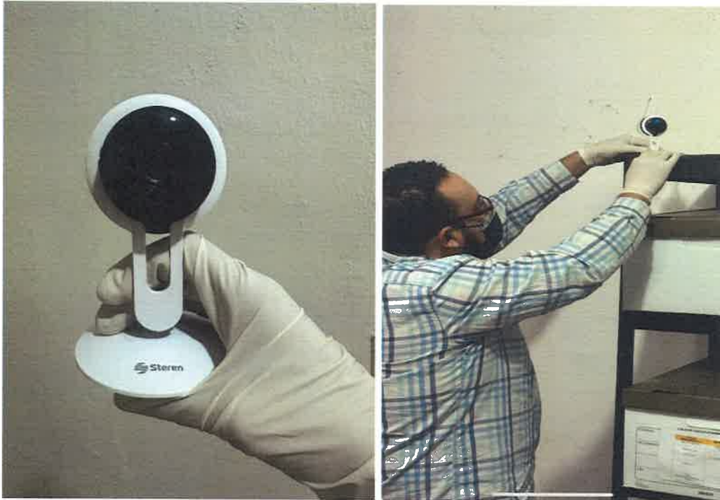
Miguel Ángel Solís Durán, Coordinador de Sistemas instalando las cámaras de video en la bodega que resguarda los archivos del Tribunal Estatal Electoral.
